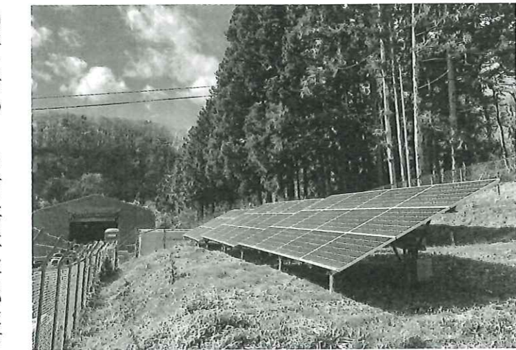
現在社内の3割の電力をまかなっている太陽光発電設備
