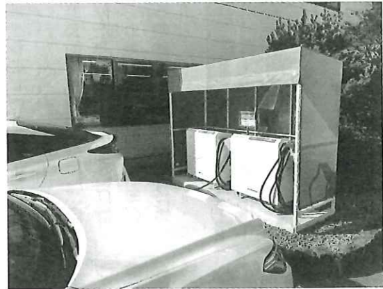
EVステーション
